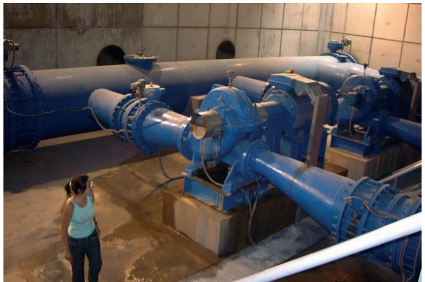
Estación de bombeo con grandes equipos en la comunidad de regantes de Lorca (Murcia)
